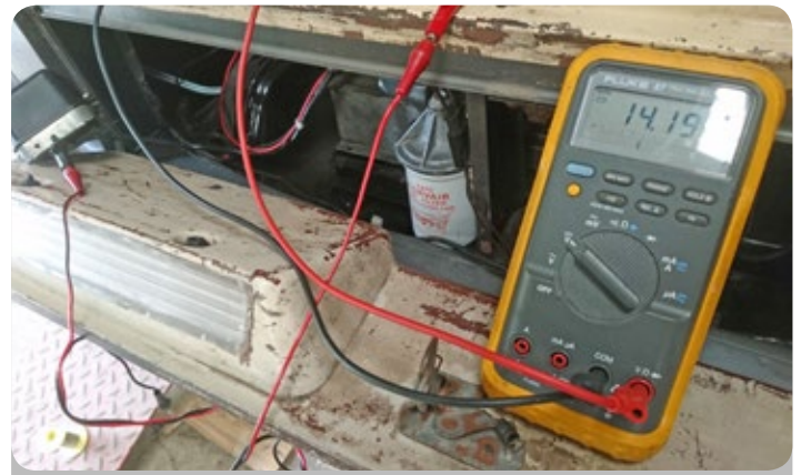
Eindelijk 14,2 Volt op de meter
