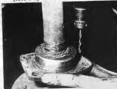
Foto 2; De klinknagels die de twee flenzen bij elkaar houden open boeren en met een doorslag de nagels geheel eruit slaan.
